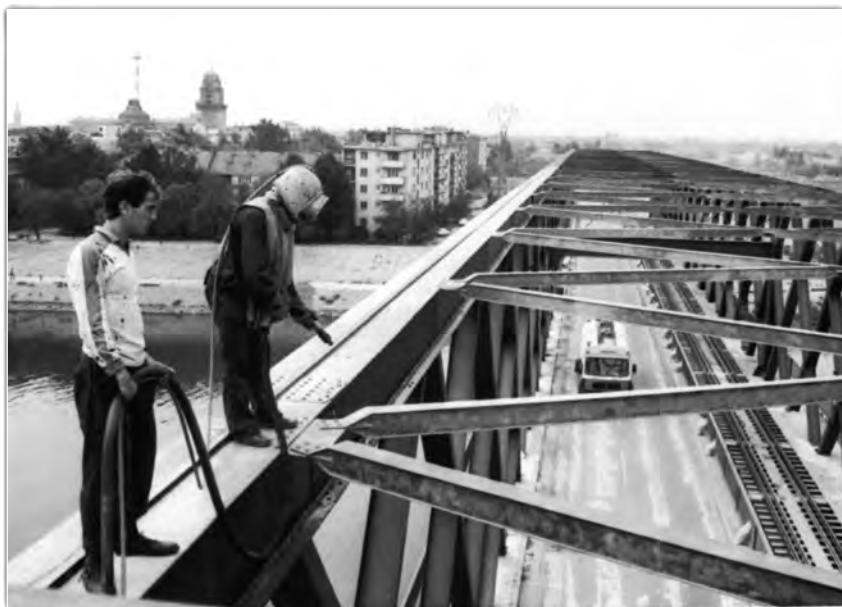
Радови на реновирању сенћанског моста 1989. (Историјски архив, Сента – из збирке Стевана Крагујевића-Штице)
